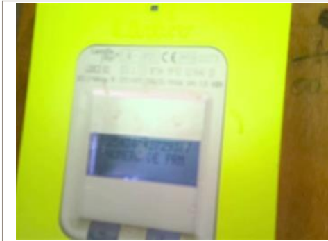
Photo du compteur ou tableau électrique
