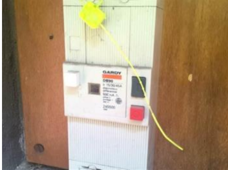
Photo du compteur ou tableau électrique
