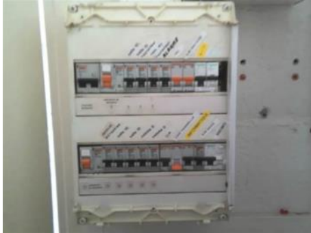
Photo du compteur ou tableau électrique
