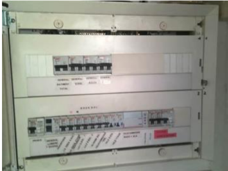
Photo du compteur ou tableau électrique
