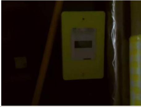
Photo du compteur ou tableau électrique
