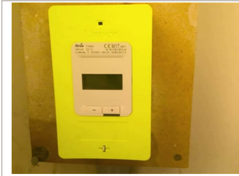
Photo du compteur ou tableau électrique
